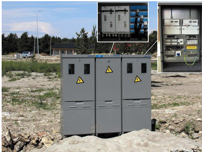
Joonis 3.44 Transiit- ja liitumiskilbid
